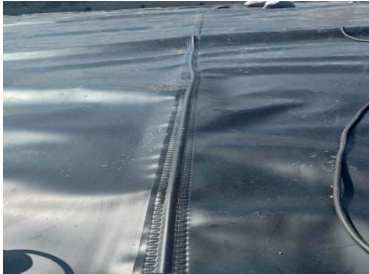
ภาพที่ 10 รอยเชื่อมแผ่น Geomembrane ที่ต่อเนื่องและมีความสม่ำเสมอ
