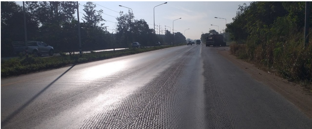
ภาพที่ 3.6 ร่องล้อที่เกิดขึ้นทางหลวงหมายเลข 344 ด้านซ้ายทาง (ธันวาคม 2566)
