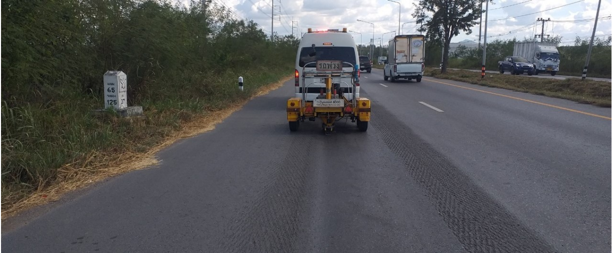
ภาพที่ 3.7 ร่องล้อที่เกิดขึ้นทางหลวงหมายเลข 344 ด้านขวาทาง (ธันวาคม 2566)
