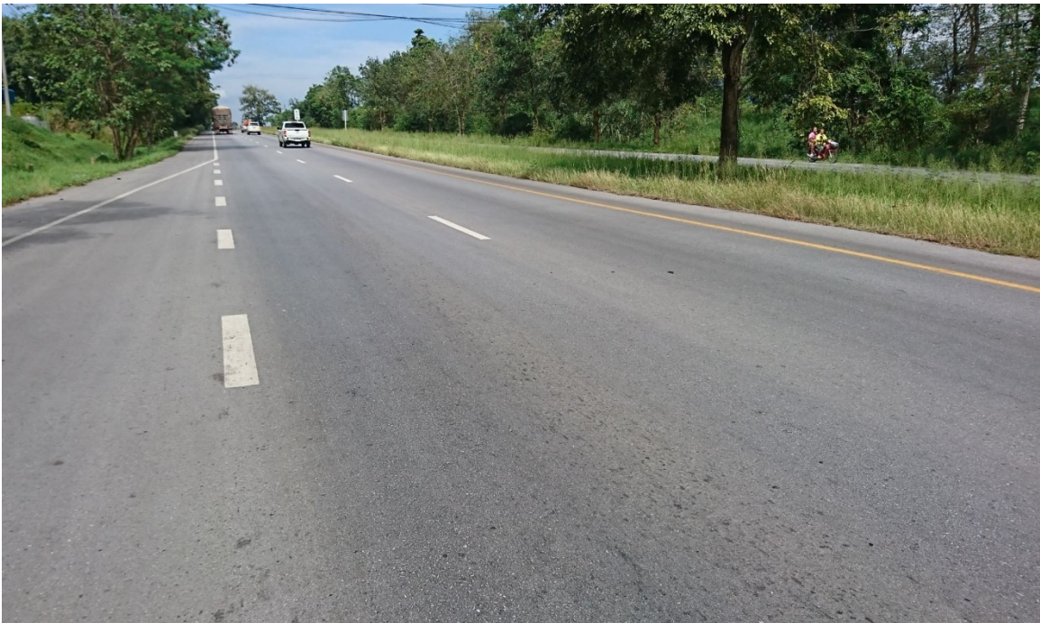
ภาพที่ 3.4 รูปภายหลังการบูรณะทางหลวงหมายเลข 344 ตอน อ.บ้านบึง – อ.แกลง กม. 56+ 000 RT
