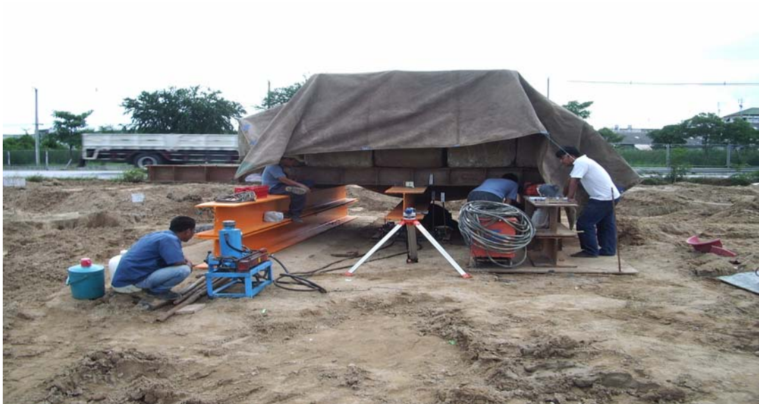
ภาพแสดงการทดสอบ Pile Load test ที่อายุครบ 28 วัน
