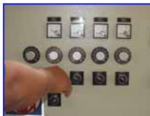
รูปที่ 24 ห้องควบคุมการทำงาน
