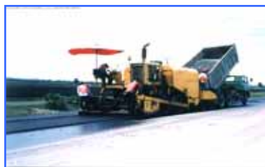
รูปที่ 6.1 Mix – Paver Travel Plant
