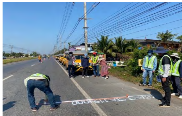
รูปที่ 1-44 พื้นที่ทดสอบอุปกรณ์ ทางหลวงหมายเลข 33 ตอน 501 ผิวทางลาดยาง ที่มีความเสียหายของผิวทางค่อนข้างมาก
