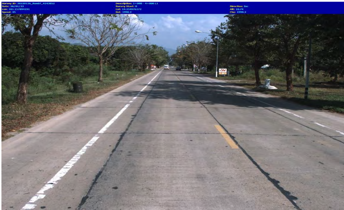
รูปที่ 1-55 ภาพถนนคอนกรีต Section 3 และ Section 4
