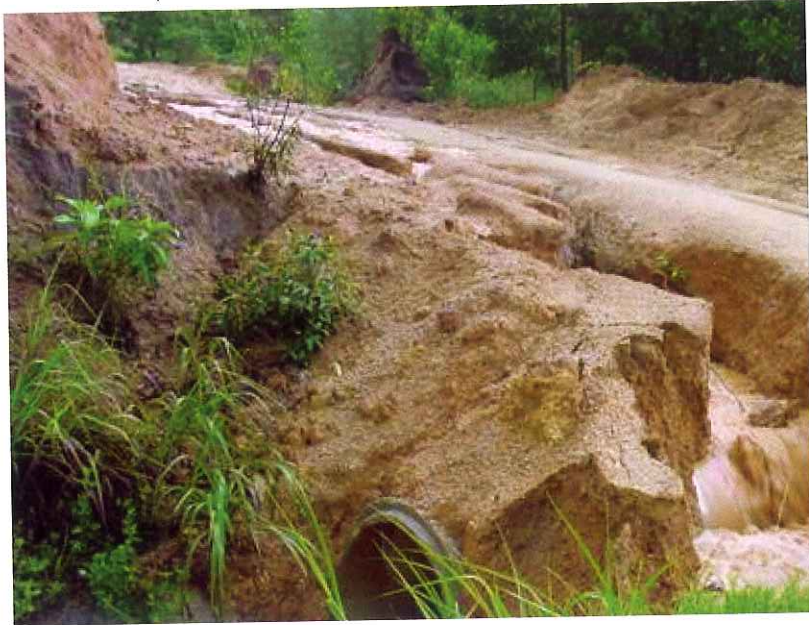
ก. การกัดเซาะหน้าดินลงสู่ระบบระบายน้ำจากการเปิดบ่อยืมดิน
