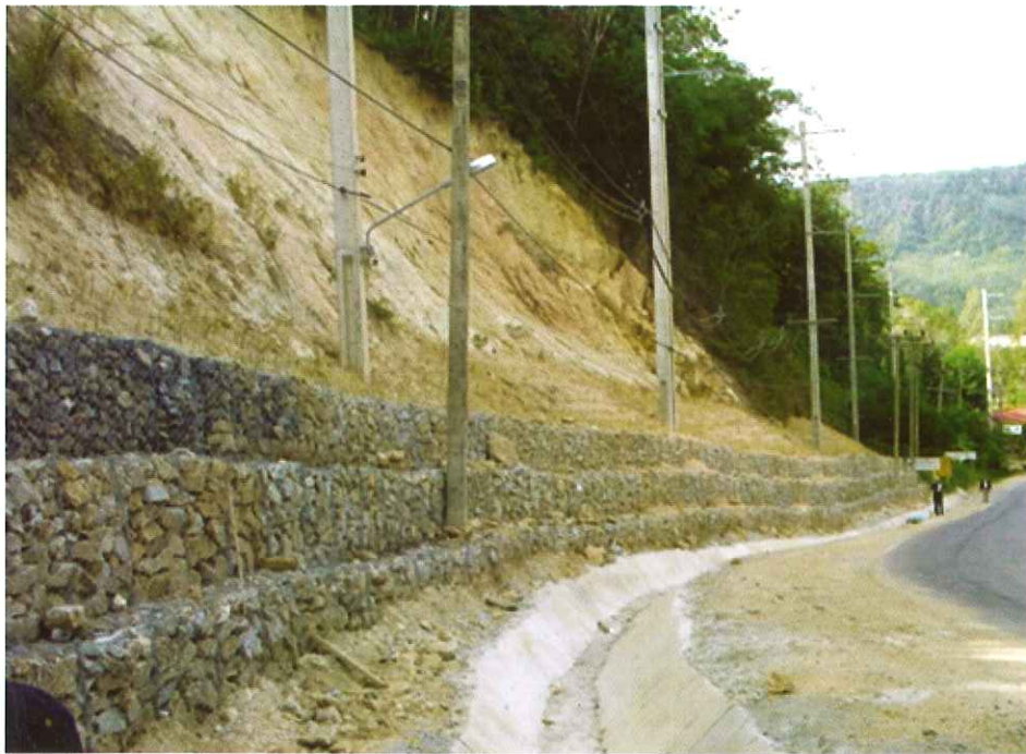
รูปที่ 24 การใช้กล่อง Gabion เพิ่มแรงต้านที่ตึนลาดดิน
