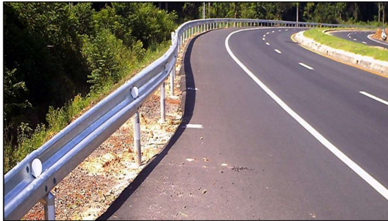
ภาพที่ 14 ราวเหล็กกลูฟูกันรถแบบ Single W-Beam Guardrail (แบบชั้นเดียว)
