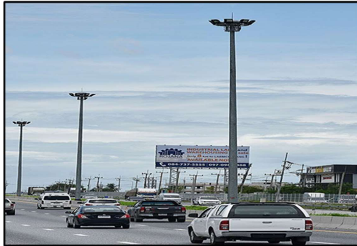
ภาพที่ 12 เสาไฟฟ้าแบบสูง (High Mast)
