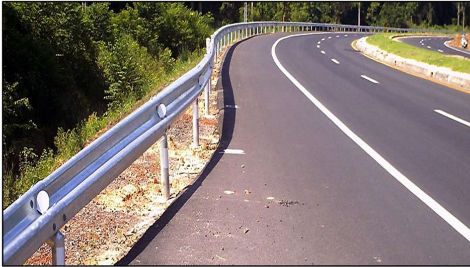
ภาพที่ 22 รูปราวเหล็กกลูฟูกันรถแบบ Single W-Beam Guardrail (แบบชั้นเดียว)
