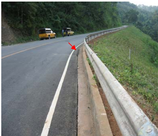
(ค) Tension Crack ของผิวทางด้านที่ก่อสร้าง ระบบ Gabion Wall (ขวามือ)
