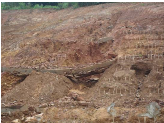
(จ) ความเสียหายของ Drain Chute
