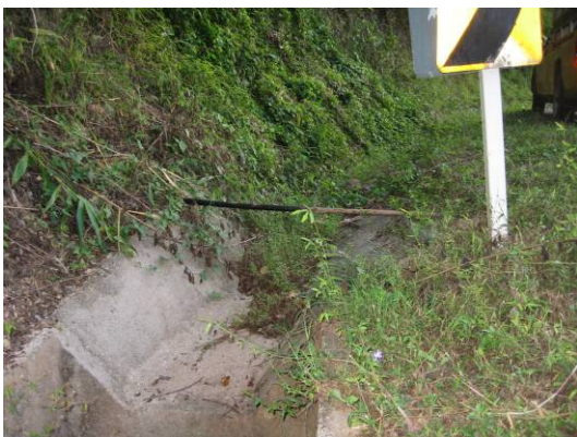
(จ) วัชพืชขึ้นบนเศษก้อนดิน/หิน ในรางระบายน้ำ
