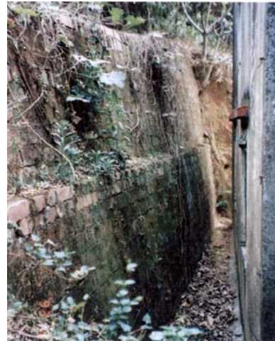
(ข) ผิวของระบบกำแพงกันดินแบบก่ออิฐ (Masonry Wall Facing) ที่ขาดการบำรุง
