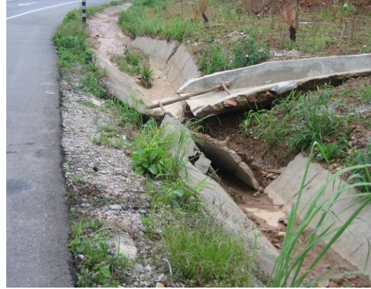
(ข) การชำรุดเสียหายของบริเวณปลาย Drain Chute และ Side Ditch ที่บรรจบกัน
