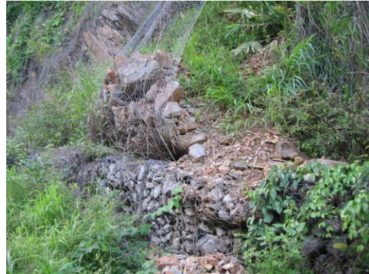
(ง) การฉีกขาดบริเวณ Toe ของระบบ Rock Fall Netting อันเนื่องมาจากขาดการบำรุงรักษา(ไม่เอาก้อนหินที่ร่วงมากองทับถมออก)
