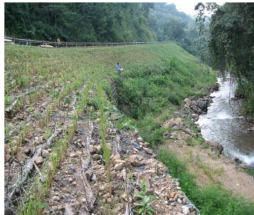
(ง) Gabion Retaining Wall ด้านลาดดินถม ที่มีร่องน้ำบริเวณ Toe Slope
