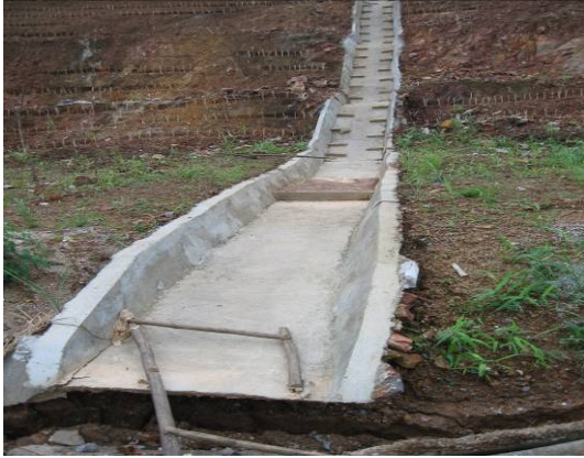
(ก) การกัดเซาะบริเวณด้านข้างและบริเวณ ปลาย Drain Chute
