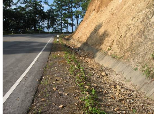
(ข) รางระบายน้ำถูกทับถมด้วย เศษก้อนดิน/หินจาก Back Slope
