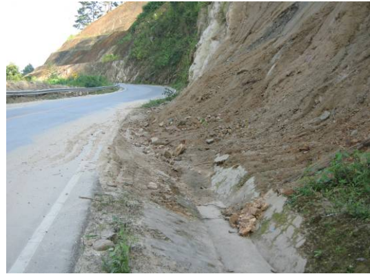
(ช) ดินด้าน Back Slope ถูกชะล้างมา ทับถมในรางระบายน้ำ
