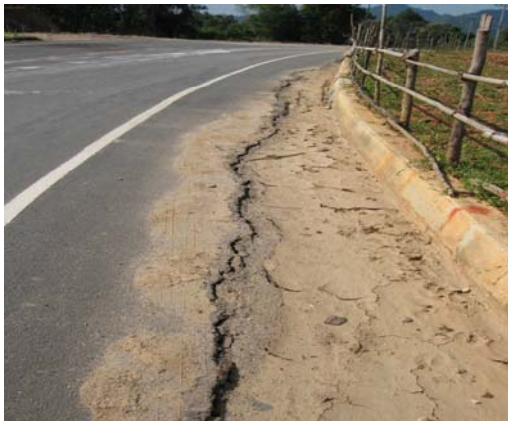
(ก) Tension Crack ของผิวทางด้านที่ก่อสร้าง ระบบ Geogrid (ขวามือ)
