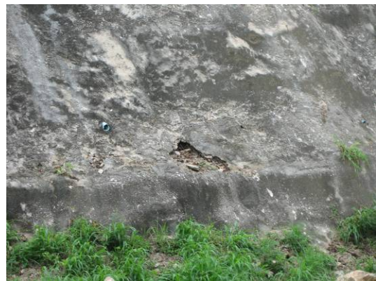
(ข) การแตกของ Shotcrete
