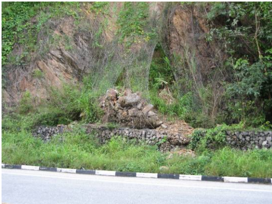
(ค) การฉีกขาดบริเวณ Toe ของระบบ Rock Fall Netting อันเนื่องมาจากขาดการบำรุงรักษา(ไม่เอาก้อนหินที่ร่วงมากองทับถมออก)
