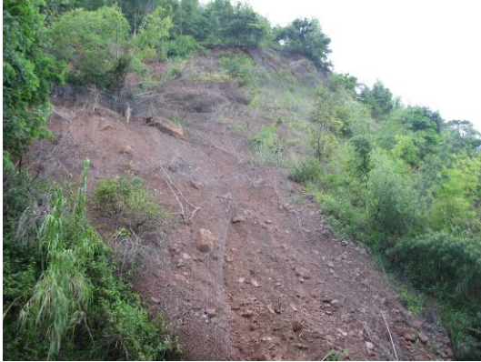
(ก) การฉีกขาดของระบบ Rock Fall Netting
