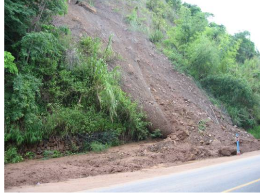
(ข) การฉีกขาดบริเวณ Toe ของระบบ Rock Fall Netting อันเนื่องมาจากขาดการบำรุงรักษา
