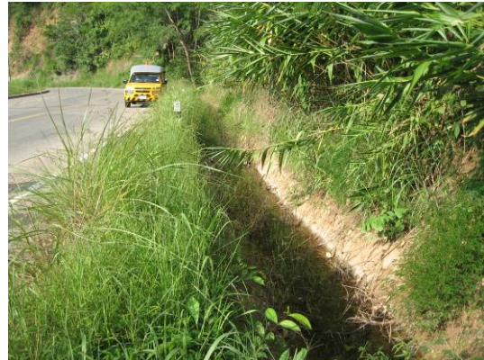
(จ) วัชพืชและน้ำขังในรางระบายน้ำ
