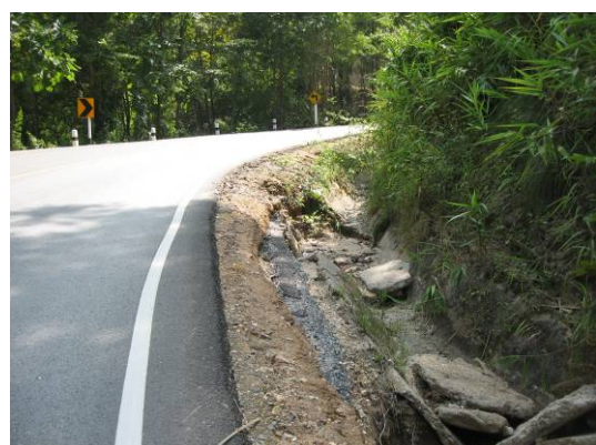
(ฉ) ก้อนหินร่วงหล่นมาทับถม ในรางระบายน้ำ
