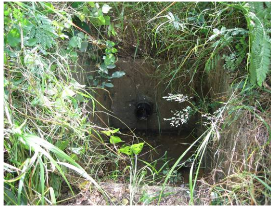
(ค) บ่อพักของ Subdrain ที่ขาดการบำรุงรักษา
