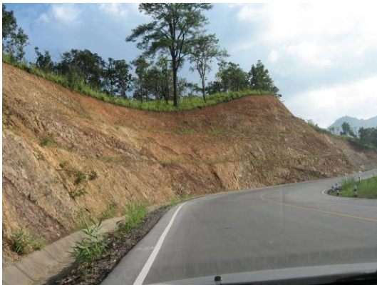
(ค) รางระบายน้ำขาดการบำรุงรักษา ไม่เอาก้อนดิน/หินออก
