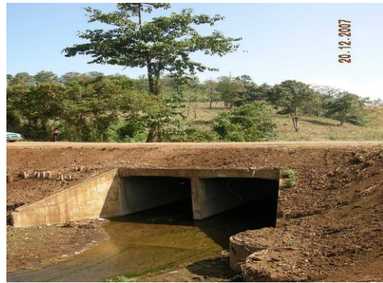
(ข) ตะกอนดินข้างหน้า Inlet ของปากท่อเหลี่ยม
