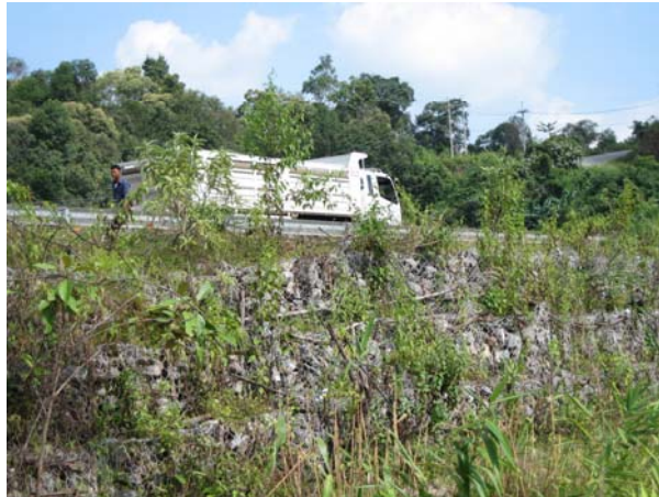
(ก) Gabion Wall ที่ไม่มีการตัดหญ้า, วัชพืช ออกตามระยะเวลา รูปที่ 2.3-8 ภาพแสดง Gabion Wall ที่ขาดการบำรุงรักษา
