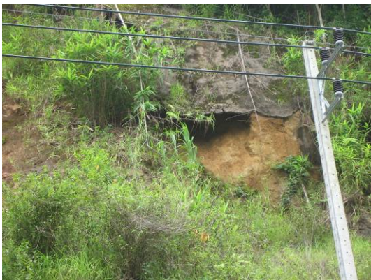
(ก) การแตกของ Shotcrete และเกิดการ กัดเซาะใต้ Shotcrete
