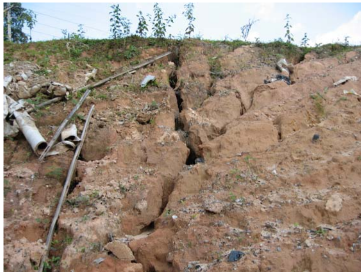
(ข) Tension Crack ของเชิงลาดดินถม
