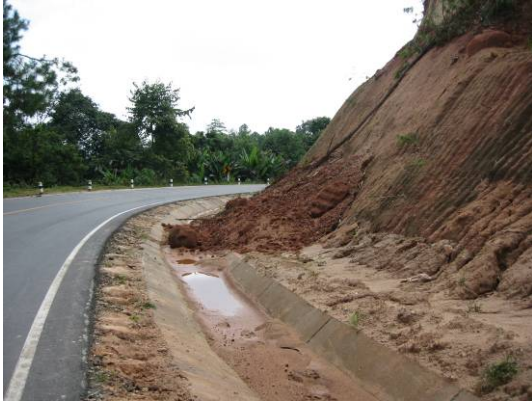
(ซ) ดินด้าน Back Slope ถูกชะล้างมา ทับถมในรางระบายน้ำ
