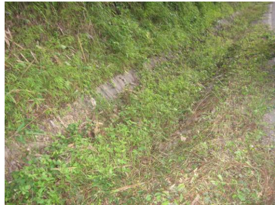
(ฅ) วัชพืชขึ้นบนดินที่มากับถมใน รางระบายน้ำ
