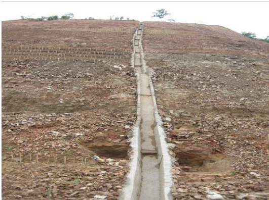
(ค) การกัดเซาะรอบๆ Drain Chute, เชิงลาด ไม่มีระบบป้องกันการชะล้าง
