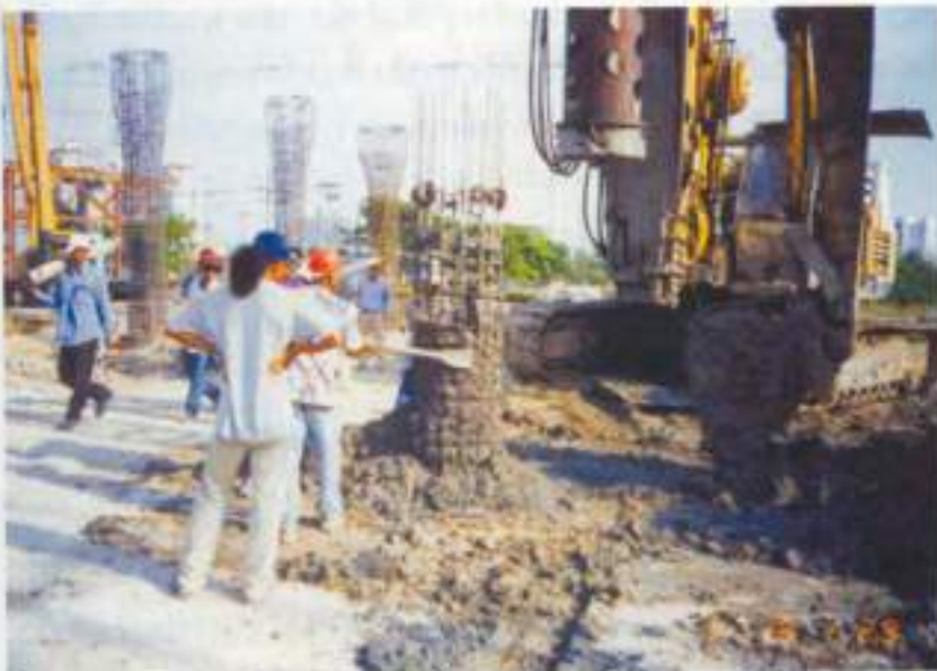
เสาเข็มเจาะที่ถอนขึ้นมาพร้อมกับปลอกเหล็ก เพราะคอนกรีตเริ่มแข็งตัว ใช้งานไม่ได้
