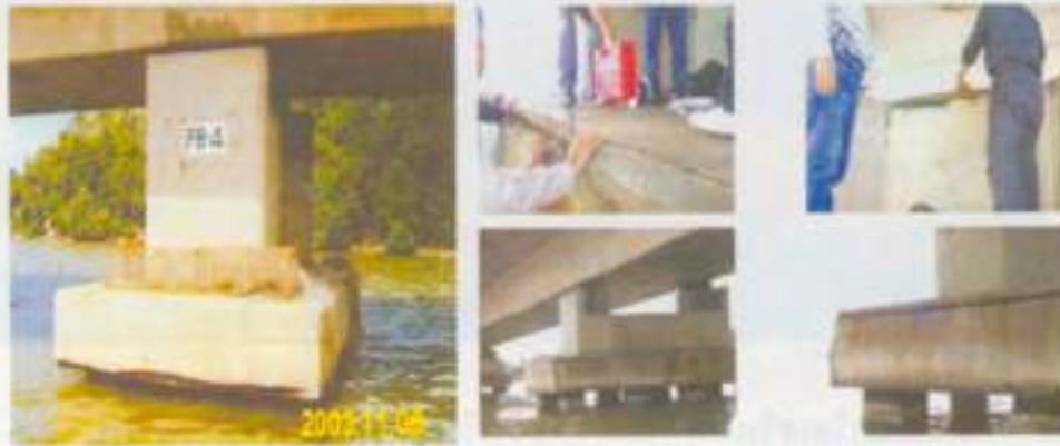
รูปที่ 1 ความเสียหายของตอม่อสะพานดินสุสานนท์ (สะพานเดิม)
