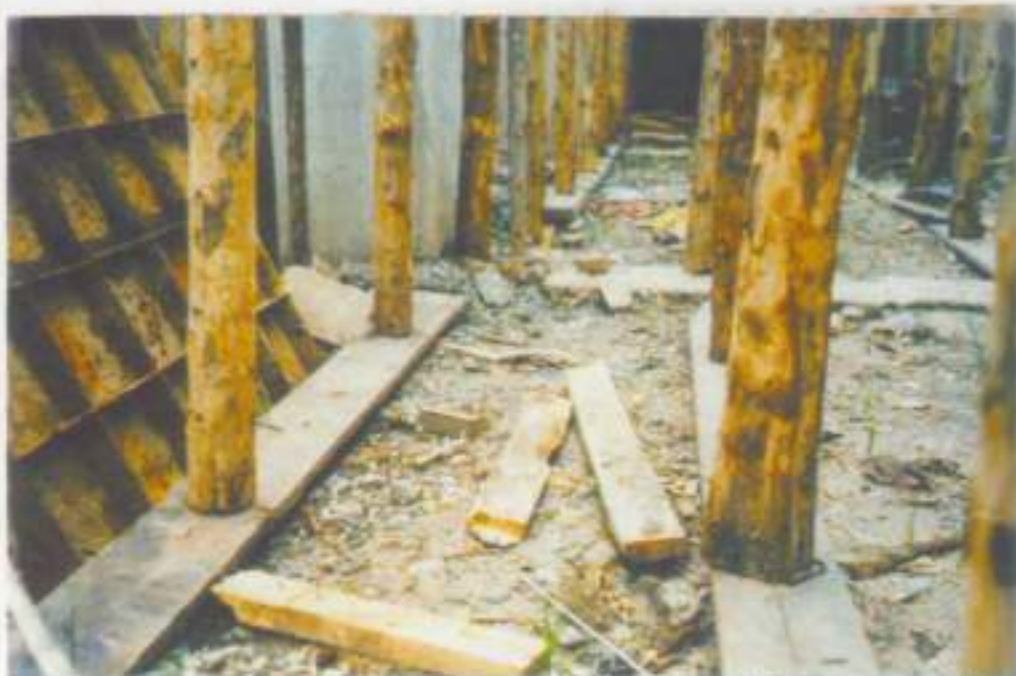
รูปที่ 19 แสดงปลายค้ำยันบนแผ่นไม้กระดานที่ไม่กระจายน้ำหนักแฉลงบนพื้นดินได้อย่างสม่ำเสมอ
