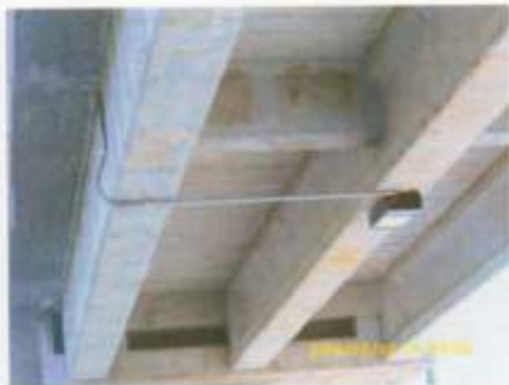
Seismic Buffer ที่ริมคานทั้งสองด้าน
