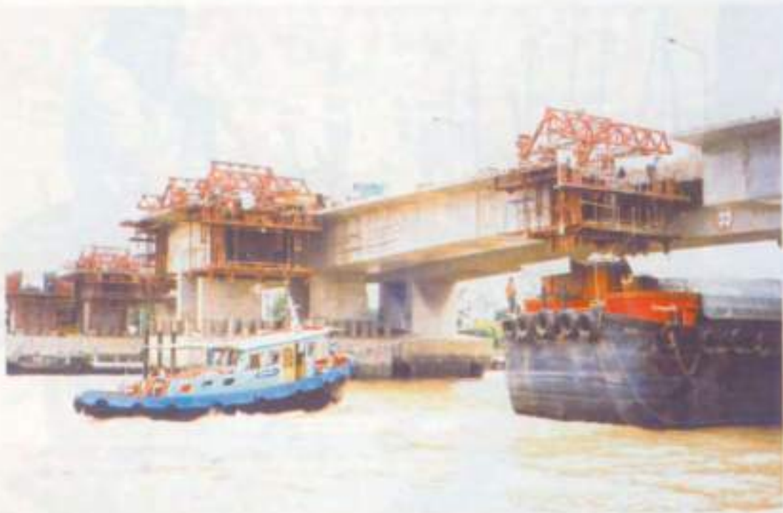
ผลกระทบที่อาจเกิดขึ้น คือ ไม่สามารถเดินเรือลอดใต้สะพานได้สะดวกขณะทำการก่อสร้าง
