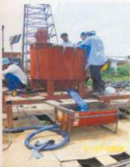
เครื่องผสมน้ำปูน (Grout Mixer) และถังวัดปริมาตร (Storage Tank)
