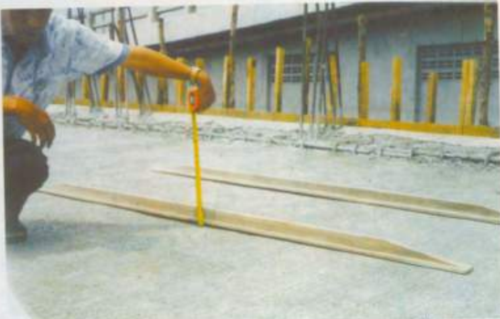
รูปที่ 17 แสดงผิวบนพื้นโครงสร้าง Bridge Approach Structure ไม่เรียบ สาเหตุเกิดการทรุดตัวของนั่งร้าน และค้ำยันด้านล่าง
