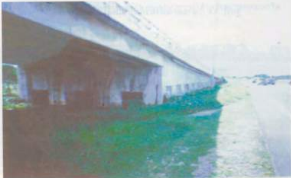
รูปที่ 16 ระดับฐาน Bridge Approach Structure ต่ำกว่าระดับถนน
