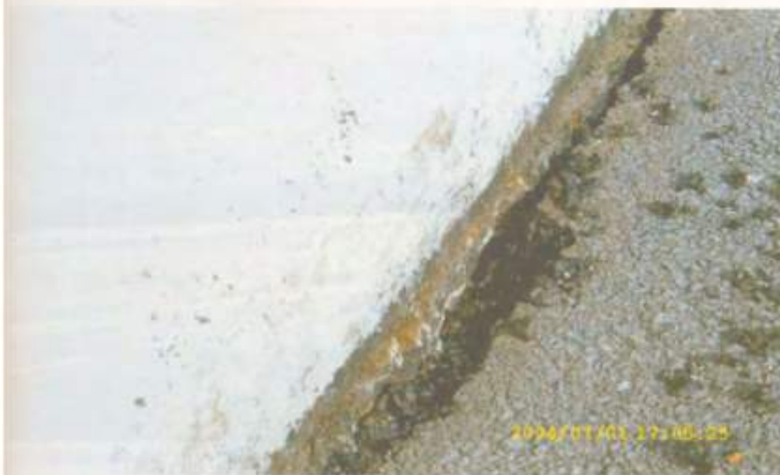
รูปที่ 34 การแยกตัวของรอยต่อระหว่างผิวลาดยาง กับ Concrete Barrier
