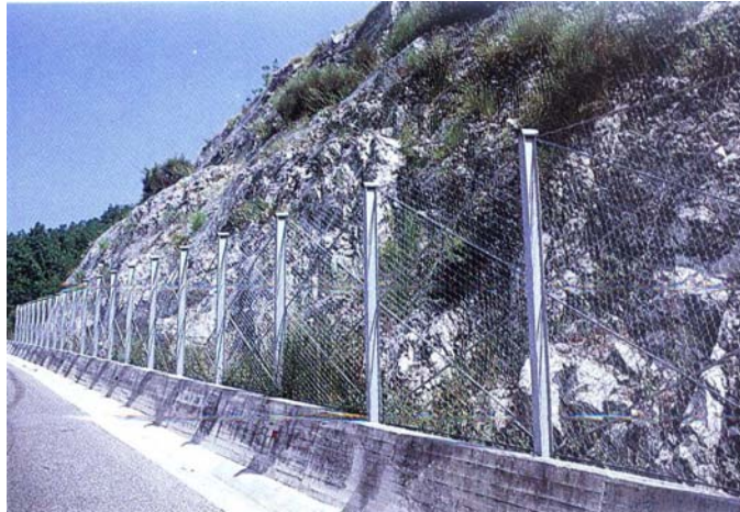
รูปที่ 4.3-33 แสดง Rock Fall Catch Fence ที่วางบน Concrete Barrier [10]
