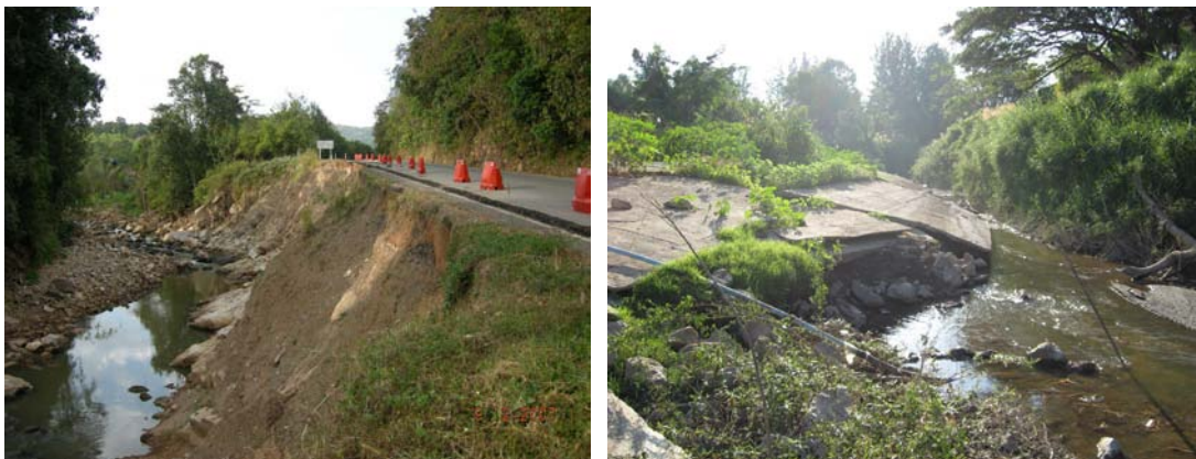
รูปที่ 3.3-1 ลักษณะความเสียหายเนื่องจากน้ำกัดเซาะบริเวณปลายเชิงลาดคันทาง
