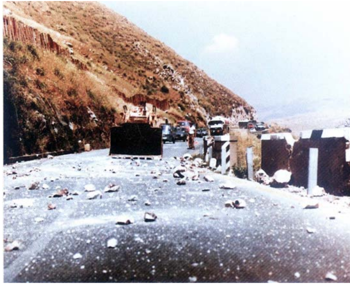
รูปที่ 3.3-20 แสดงหินร่วงกีดขวางการจราจรและปฏิบัติการตัดกออก [10]
