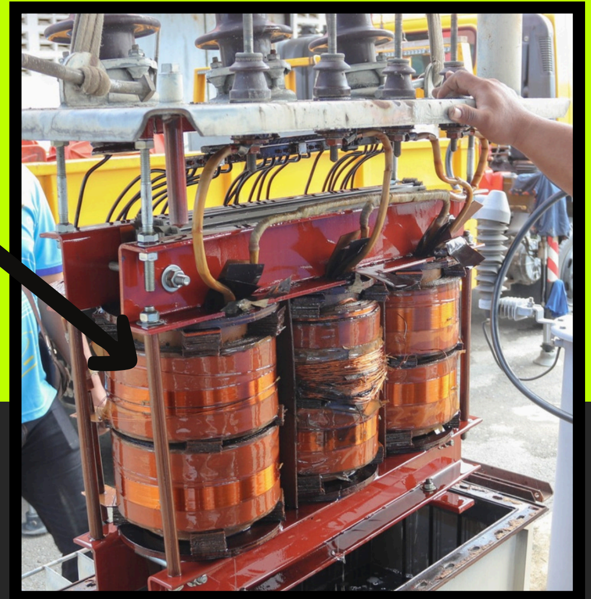
หม้อแปลงระบบ3เฟส
