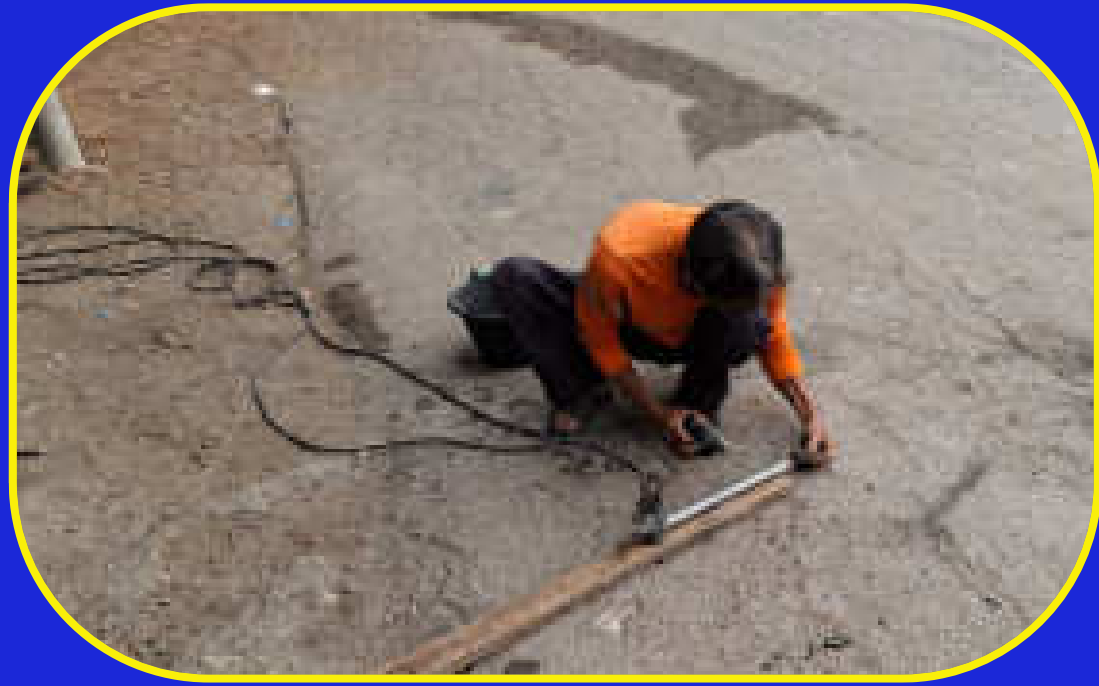
1. นำโครงสร้างเหล็กที่ชำรุดมาตัดเพื่อทำเป็นคั่นส่งแรงและด้ามจับ
