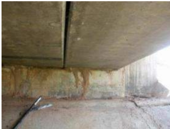
รูปที่ 4-73 การสะสมของเศษดินบริเวณรอยต่อสะพาน
