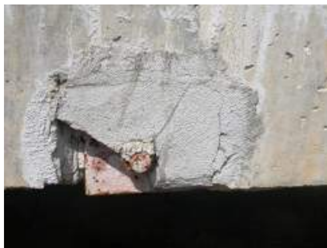
รูปที่ 3-17 แสดงเหล็กที่ได้รับความเสียหาย
