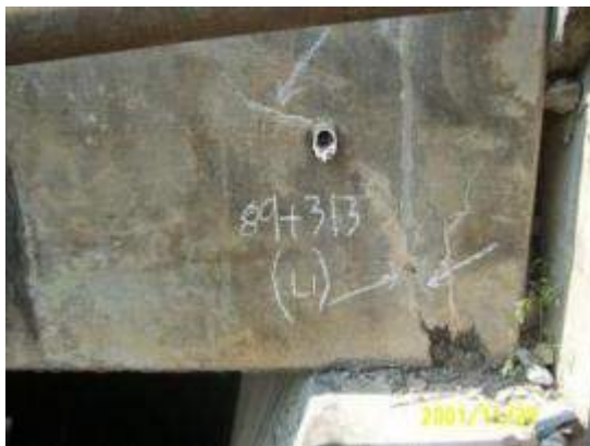
รูปที่ 4-20 รอยแตกจากแรงเฉือนใกล้แผ่นรองรับคาน
