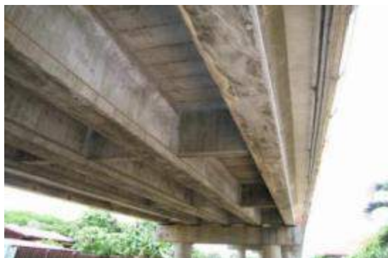
รูปที่ 4-22 การเกิดคราบเกลือที่ไหลมาตามน้ำ
