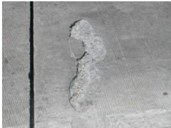
รูปที่ 3-16 แสดงพื้นคอนกรีตที่ได้รับความเสียหาย
