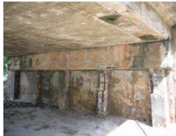
รูปที่ 4-94 สภาพความเสียหายของกำแพงกันดินที่มีการหลุดล่อนจนเห็นเหล็กเสริม
