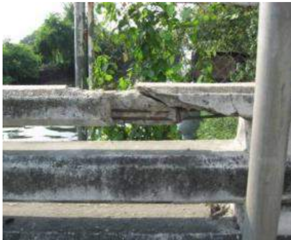
รูปที่ 4-83 สังก่อนจนเห็นเหล็กเสริม
