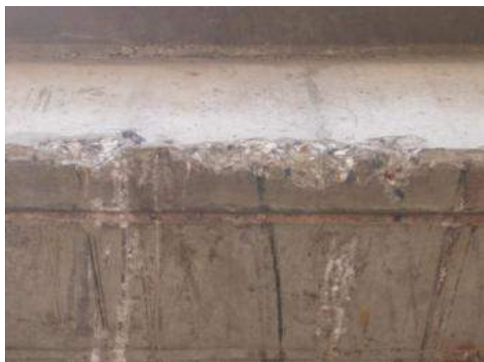
รูปที่ 4-8 การเสียหายจากการถูชนของพื้นด้านล่าง
