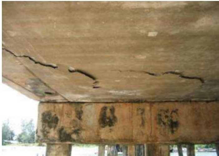
รูปที่ 4-3 การหลุดแยกออกเป็นแผ่นๆ ได้แผ่นพื้นสะพาน
