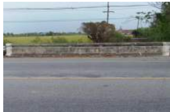
รูปที่ 5-15 ราวสะพานด้านขวา (3-สภาพพอใช้)
