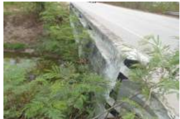
รูปที่ 5-21 ราวสะพานด้านขวา (3-สภาพพอใช้)
