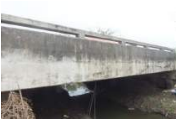
รูปที่ 5-32 ราวสะพานด้านขวา (3-สภาพพอใช้)
