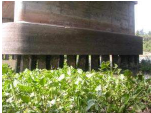
รูปที่ 4-41 แสดงการกัดเซาะบริเวณตอม่อ
