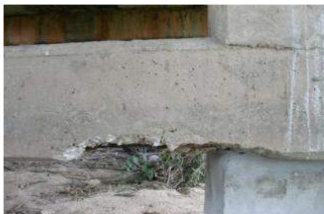
รูปที่ 4-34 มีการหลุดล่อนจนเห็นเหล็กเสริม
