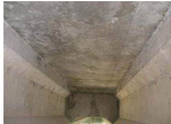
รูปที่ 4-25 ผิวคอนกรีตสึกกร่อน
