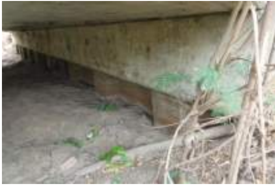
รูปที่ 5-28 คานรัดหัวเสา (4-สภาพดีพอใช้)
