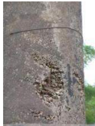
รูปที่ 4-45 ผิวตอม่อเป็นโพรงและเมื่อปะทะกับกระแสน้ำทำให้เกิดความเสียหายมากขึ้นจนมองเห็นเหล็กเสริม
