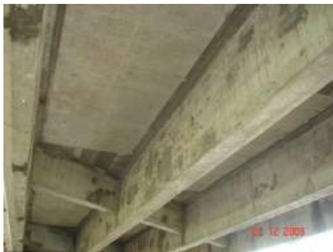
รูปที่ 2-6 สะพานแบบคานคอนกรีตเสริมเหล็กรูปตัวทีหล่อในที่ (RC T-Girder)
