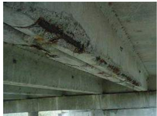
รูปที่ 4-21 การเกิดหลุดล่อน
