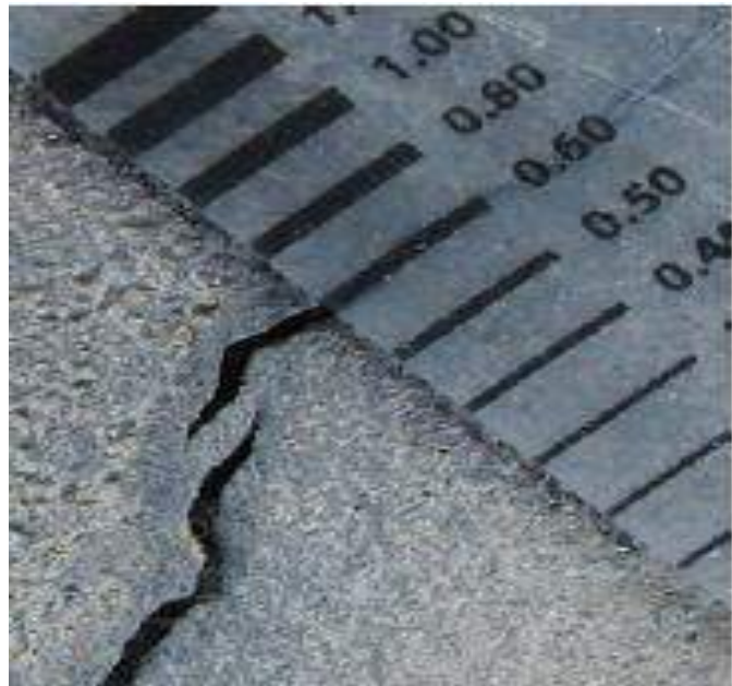
รูปที่ 4-1 แสดงการวัดรอยแตก (Crack Gauge)
