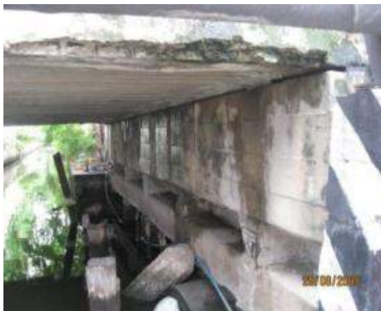
รูปที่ 4-44 ความเสียหายบริเวณเสาตอม่อสะพานที่คอนกรีตกะเทาะออกจนสามารถเห็นเหล็กเสริมได้
