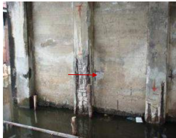
รูปที่ 4-50 มีการหลุดล่อนจนเห็นเหล็กเสริม
