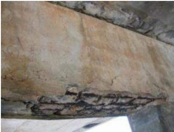
รูปที่ 4-27 หลุดล่อนบริเวณคานรัดหัวเสา
