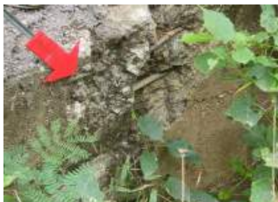
รูปที่ 4-58 เกิดการหลุดล่อนจนเห็นเหล็กเสริม
