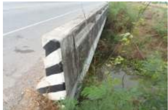
รูปที่ 5-13 ราวสะพานด้านขวา (3-สภาพพอใช้)
