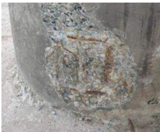
รูปที่ 4-46 การหลุดล่อนของคอนกรีตบริเวณโคนตอม่อ
