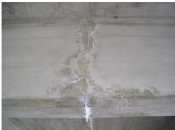
รูปที่ 4-24 มีน้ำซึมระหว่างรอยต่อ
