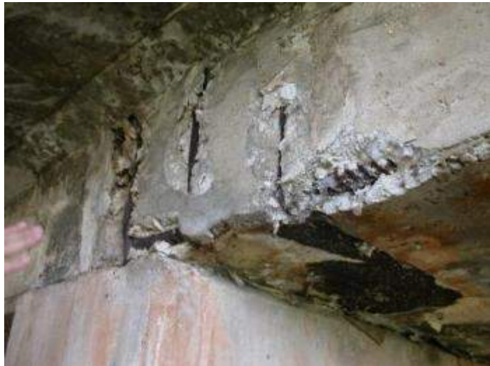
รูปที่ 4-4 การหลุดล่อนใต้แผ่นพื้นสะพาน
