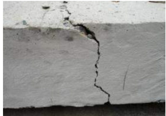
รูปที่ 4-19 รอยแตกจากการดัด (Flexure Cracks)
