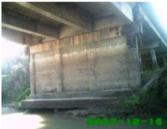
รูปที่ 4-52 เกิดการกัดเซาะของดินบริเวณฐานราก
