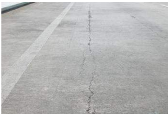
รูปที่ 4-10 ความเสียหายที่เกิดจากการบรรทุกน้ำหนักเกิน
