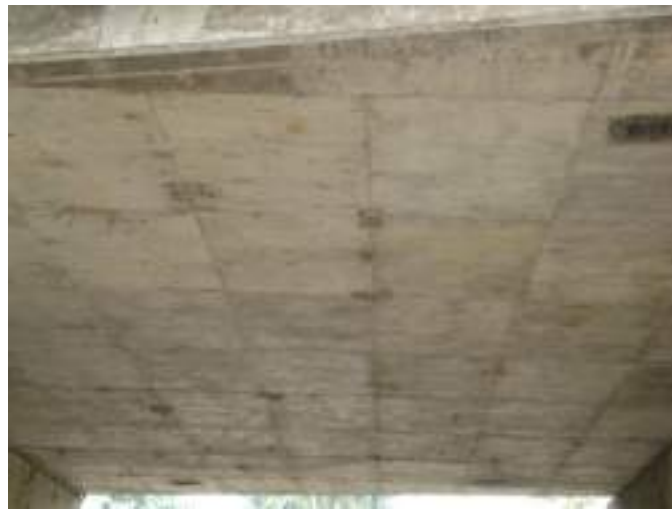
รูปที่ 2-1 สะพานคอนกรีตเสริมเหล็กแบบหล่อในที่ (RC Slab Type)
