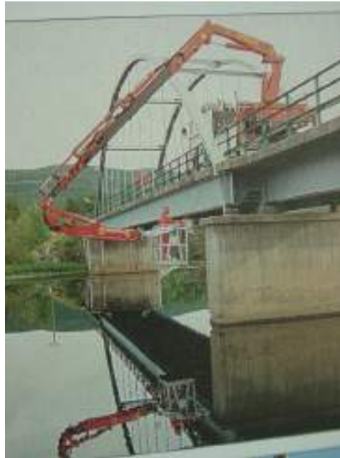
รูปที่ 3-15 แสดงการตรวจสอบโครงสร้างสะพานโดยการใช้อุปกรณ์เฉพาะ
